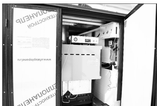
С новой котельной тепло поступает на школу
