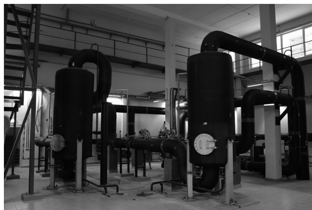
Рис. 8. ГИГ-450 на прямом и обратном трубопроводе ЦТП
