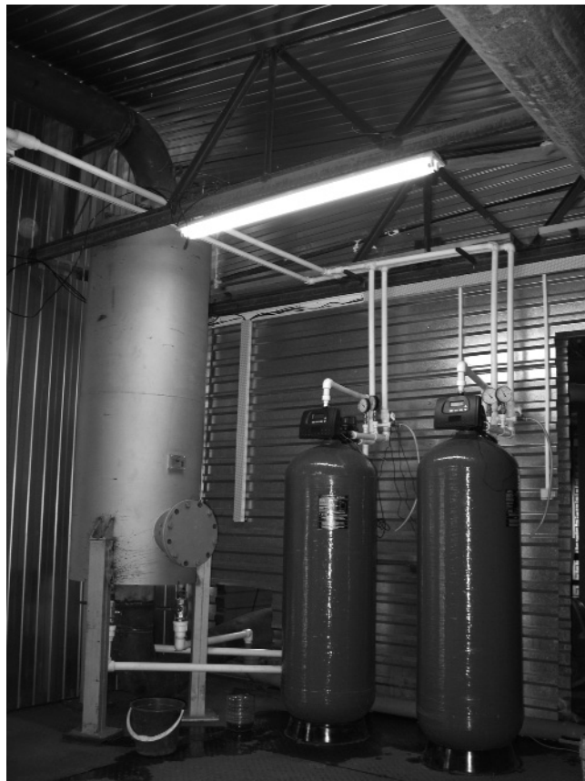
Рис. 6. Фильтр-грязевик ГИГ-350 и сорбционные фильтры станции обезжелезивания
